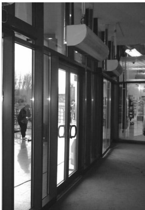
Рисунок 4.28. Горизонтальные тепловые завесы над входными дверями
