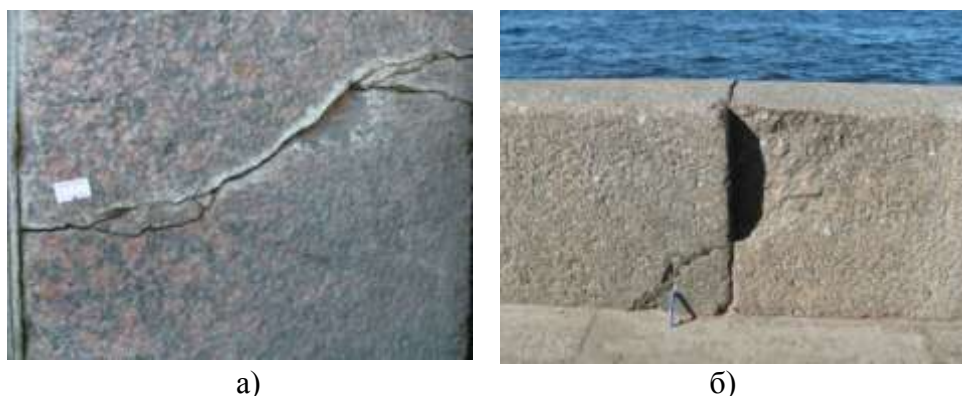
Рис. 1. Трещины и сколы гранита на набережных Санкт-Петербурга: а) набережная реки Мойки, напротив дома № 124; б) Дворцовая набережная, напротив дома № 14/16
